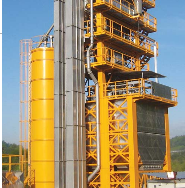
Двойной бункер готовой смеси, 170 тонн Twin Hot Mix silo with 170 tons capacity
