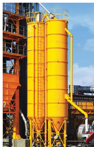
Отдельные силосы минпорошка и пыли Separate filler silos
